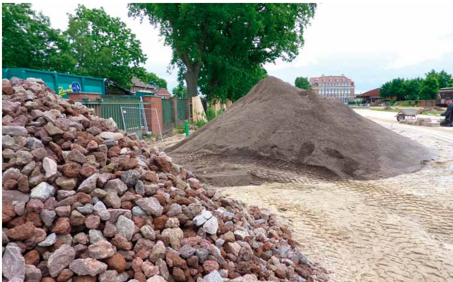
Im Bildvordergrund liegt das „Stützkorn“ des „unverdichtbaren“ Substrats, dahinter der getrennt angelieferte „Feinboden“, das Bims-Xylit-Gemisch. Links die zu sanierenden Eichen und die Mauer, zur Straße hin.
