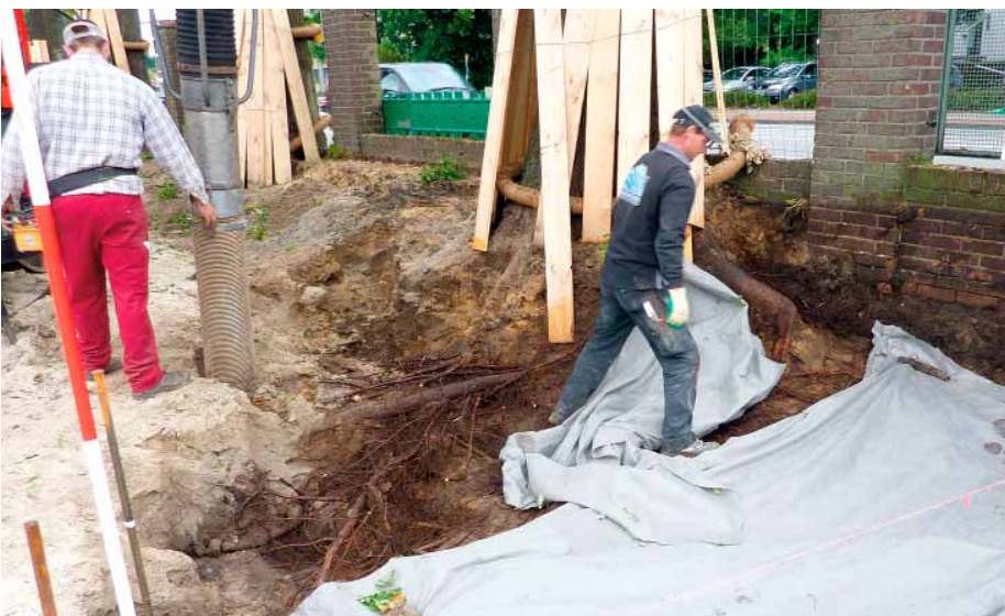
Der Sandboden wurde mit einem Saugbagger abgesaugt. Um weitere Wurzelschäden zu vermeiden, wurden die verbliebenen Wurzeln mit einem Vlies abgedeckt und feucht gehalten.
