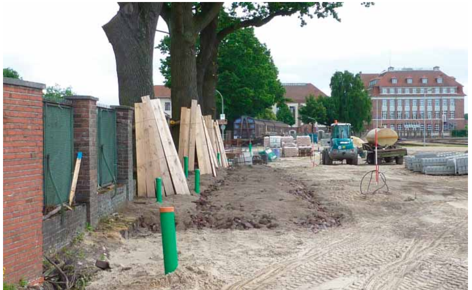
Die grünen, senkrecht stehenden Rohre sind die Verbindung zu den Belüftungs- und Bewässerungselementen und werden oberflächengleich abgeschnitten und mit einer weitgehend offenen Abschlusskappe versehen.
